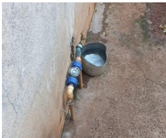
Foto: Hidrômetro a ser trocado Elaboração: Mundo Arquitetura
